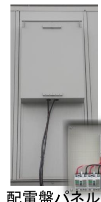
配電盤パネル
