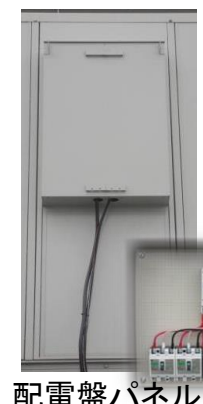
配電盤パネル
