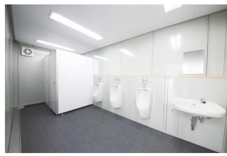
サニタリーユニット
