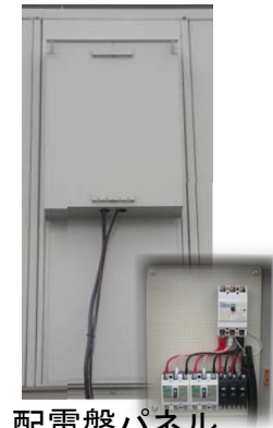
配電盤パネル
