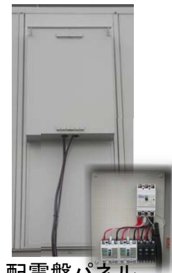
配電盤パネル
