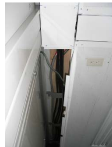
EPS天井(電気配線の天井埋込型)
