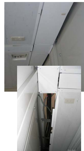
EPS天井(電気配線の天井埋込型)
