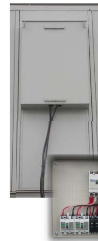
配電盤パネル
