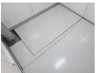
側溝・鋼製溜枳
